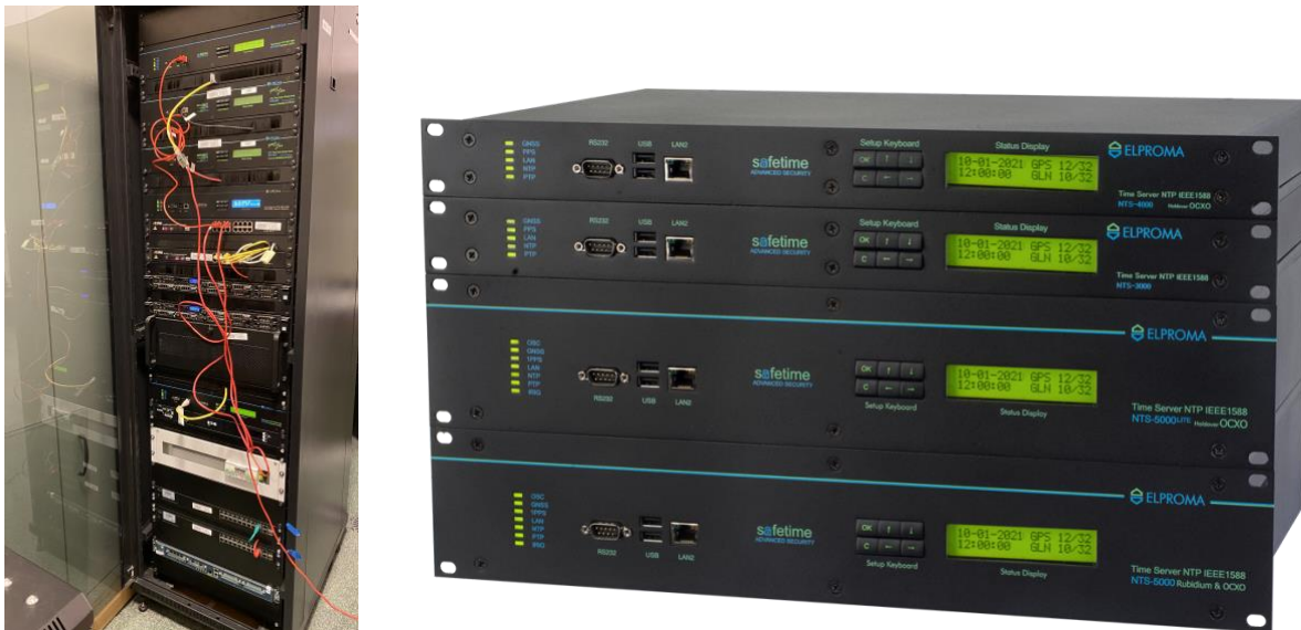
Rys. 26. Węzeł systemu synchronizacji „Klepsydra” w Polskiej Agencji Żeglugi Powietrznej, część rozproszonej architektury synchronizacji jaką dysponuje PAŻP w układzie konwergencji międzymiejskiej. Prezentowany węzeł zawiera 5 serwerów klasy NTS-5000, w tym jeden atomowy.
