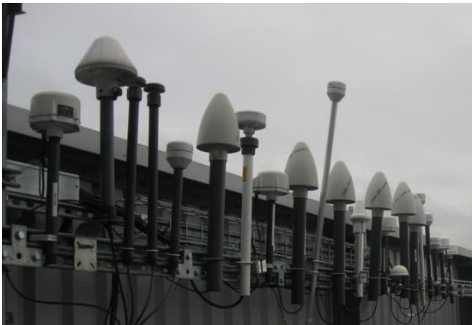
Rys. 29. Widok anten GNSS zamontowanych na dachu budynku infrastruktury krytycznej. Inspekcja dostarcza informacji o ilości systemów zależnych od GPS i jakości instalacji oraz daje pogląd w sprawie okresu pochodzenia poszczególnych rozwiązań zależnych od GPS.
